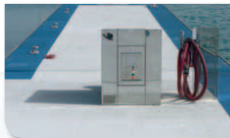
Pompe de quai. Quayside pump out. Bomba del muelle del puerto.
