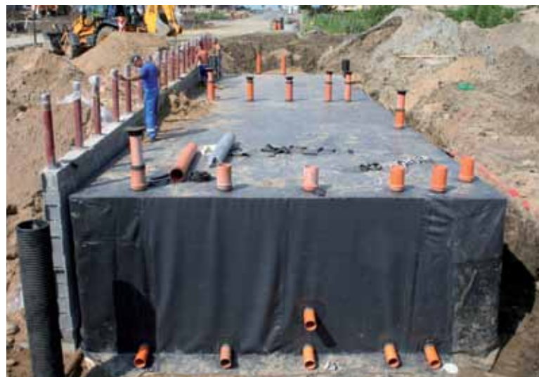
Буферный резервуар в дренажной системе
