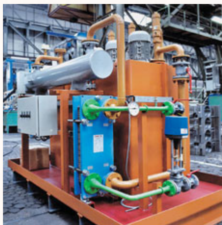
Охлаждение машинного масла в металлопрокатной промышленности
