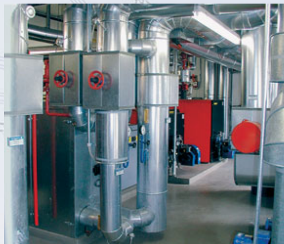
ПТО в системах отопления
