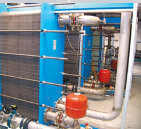
Центральный охладитель для стенда испытаний моторов
