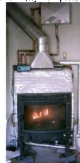
ПРАВИЛЬНИЙ монтаж відсутність резервуару
