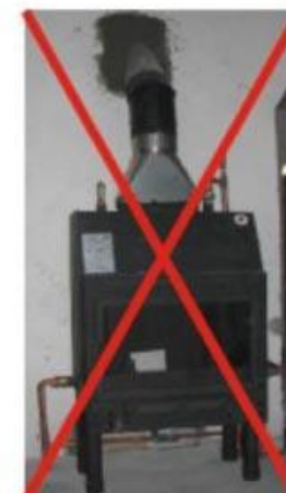
НЕПРАВИЛЬНИЙ монтаж відсутність резервуару
