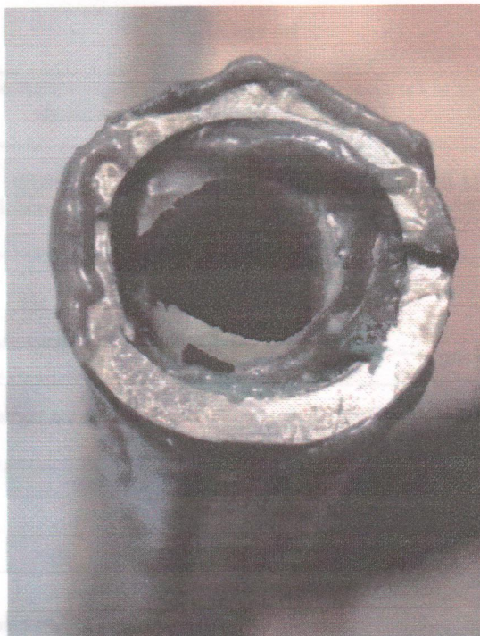
Рис.3 Руйнування композитної арматури по зовнішньому шару
