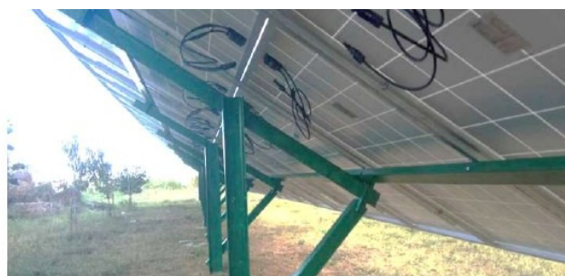
Кабельна зона та опорна частина
