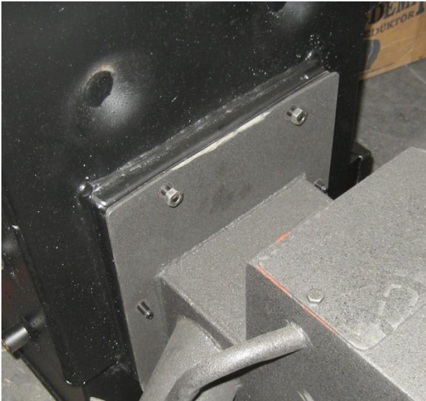
Малюнок 17 - Встановлений на котлі корпус шнекової подачі.
