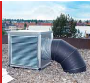
Установка на крыше с защитным козырьком и решеткой (комплектующие).
