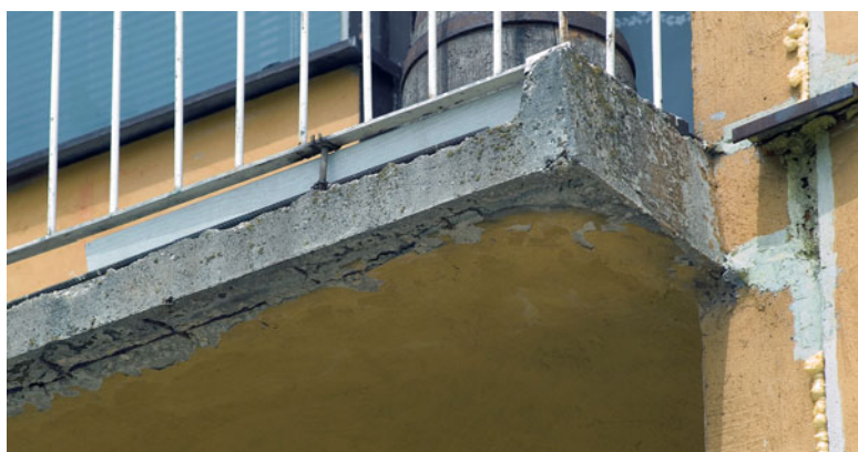
Рис. 1. Отслаивание бетона по краям балкона
