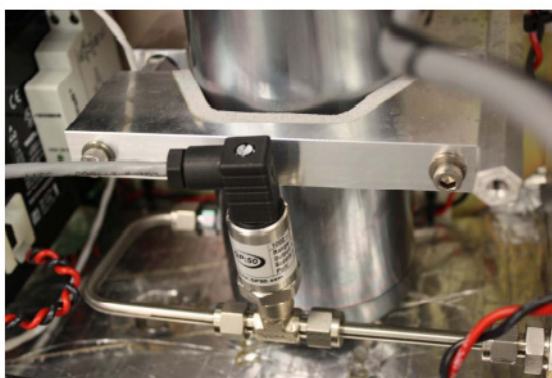
Рис. 40. После установки нового датчика давления
