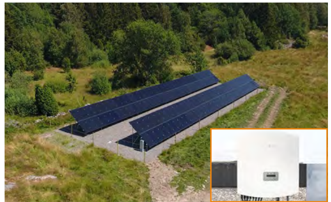
Västra Götaland, Sweden 43.31kW
