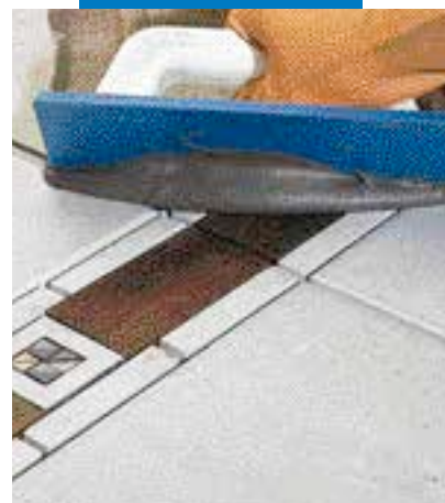
Заполнение швов в напольной керамической плитке со вставками из дерева с помощью резинового шпателя
