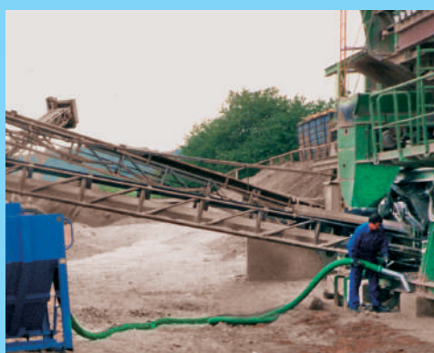
Очистка ленточного транспортера
