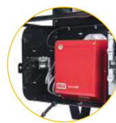
Внутри защитного бокса: горелка RIELLO, электронная панель управления.
