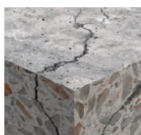
Бетон с трещинами
