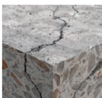
Бетон с трещинами
