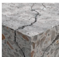
Бетон с трещинами
