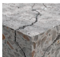
Бетон с трещинами
