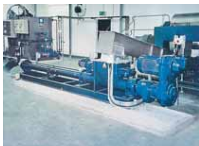
Насосы seeplex BTI 17-48 . Продукт: обезвоженный шлам из центрифуги с примерно 25% сухого остатка.
