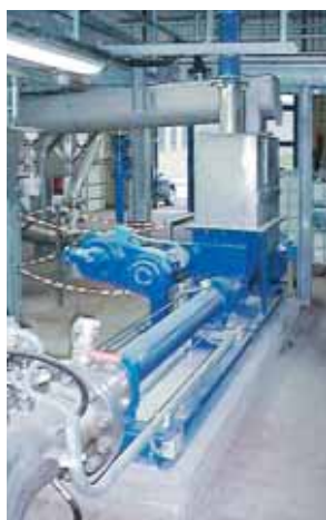
Насос сеерех VTI 35-24. Продукт: обезвоженный шлам с 20% сухого остатка из центрифуги. Особенность: В съемную воронку насоса добавляется известь. Шлам с 35% сухого остатка транспортируется к месту хранения шлама. Напорный трубопровод выполнен с местами впрыска смазки с целью окращения потерь давления.
