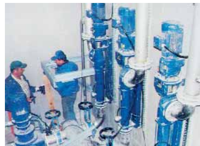
Насосы BN 35-6L и мацераторы seerex I 110 . Продукт: первичный шлам к септической камере. Особенность: насосы в связи с тесными условиями в насосном прямке смонтированы вертикально на стене.
