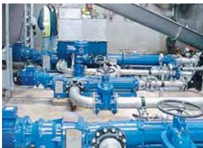
Насосы seerex BT 70-12 и BN 52-6L . Продукт: импортрованный обезвоженный шлам с 30% сухого остатка и первичный шлам примерно с 1 - 2% сухого остатка. Особенность: обратное перемешивание импортрованного шлама с первичным шламом примерно до 6% сухого остатка и дальнейшая транспортировка к септической камере. Первичный шлам подается сбоку в загрузочную воронку.
