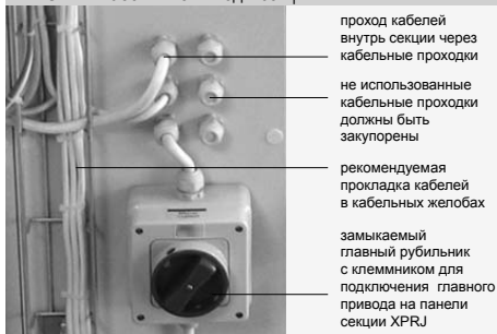
Рис. 4 – кабельные выходы секции
