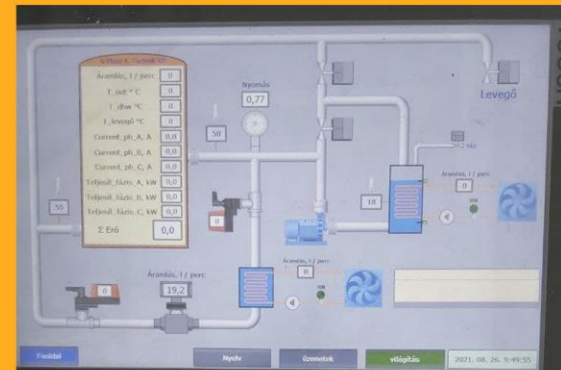
Перевірка роботи всіх комплектуючих
