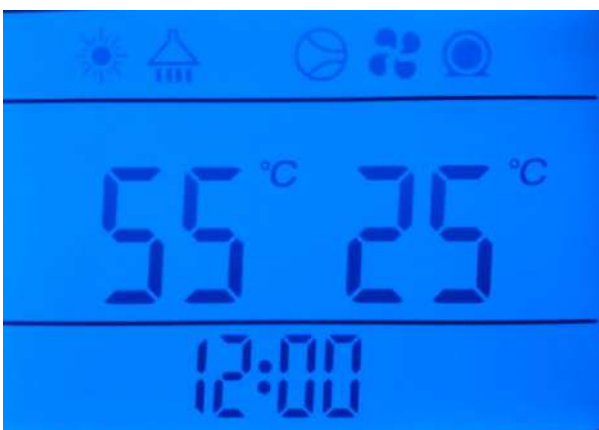
Состояние нагрева + ГВС
