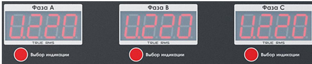
Рисунок 2. Зовнішній вигляд панелі керування
