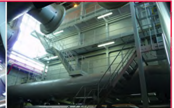
ТЕЦ-2 116,3 МВт Латвія, м. Рига Котел: Novotherm-116 – 1 шт.
