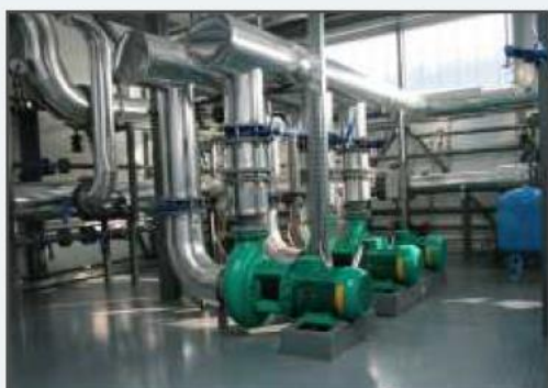
ОВК и водоснабжение
