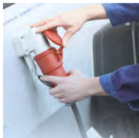
Подключение к сети питания на строительной площадке
