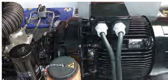
Двигатель переменной частоты мощностью 30 кВт
