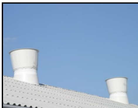
Выпускная труба на крыше
