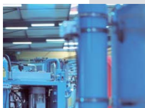
Аккумуляторы и их оснащение
