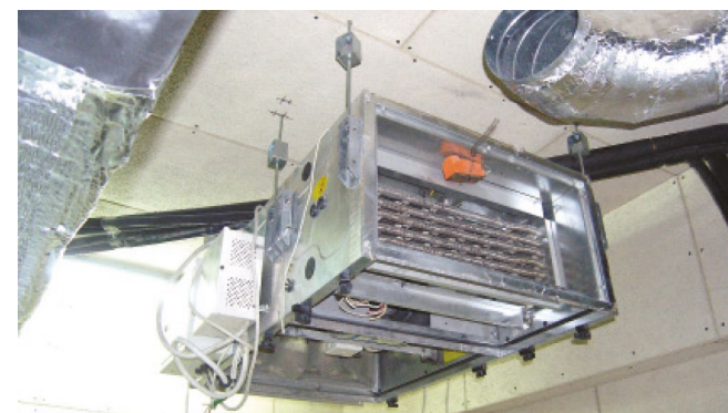
Виброизоляция подвесного фанкойла Виброизоляторы: Vibrofix Box Объект: телекомпания "Новый канал", Киев
