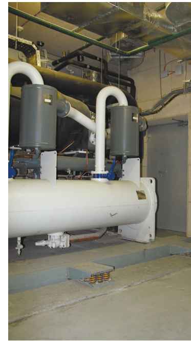
Виброизоляция чиллера Виброизоляторы: Vibrofix Spring DSD Объект: отель Hilton, Киев
