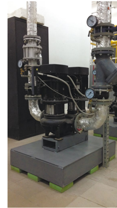
Виброизоляция насосной группы Виброизоляторы: Vibrofix Block Объект: жилой комплекс, Киев
