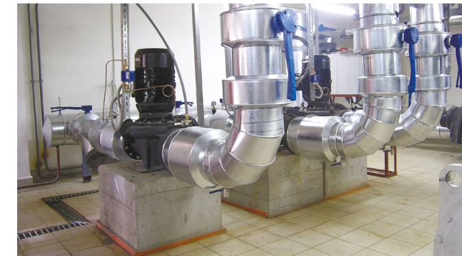
Виброизоляция магистральных насосов Виброизоляторы: Vibrofix Block Объект: отель Fairmont, Киев
