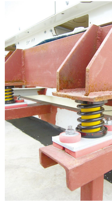
Виброизоляция промышленного кондиционера Виброизоляторы: Vibrofix Spring DSD Объект: телеканал "1+1", Киев
