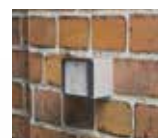
Ключ-выключатель, установленный с внешней стороны объекта
