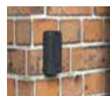
Фотоэлементы, установленные с внешней стороны объекта
