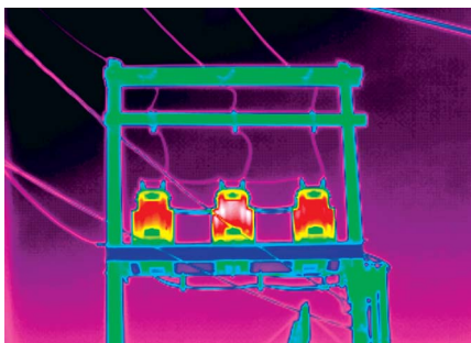
Рис. 5-40. Трансформатор, который теплее других на воздушном блоке, может указывать на возможную проблему.
