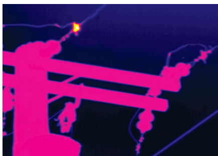
Рис. 5-16. Соединение с высоким сопротивлением на перемычке (возможно вследствие коррозии) может иметь значительные последствия при дальнейшем увеличении нагрузки.
