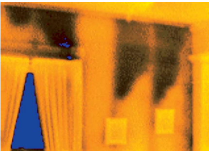
Рис. 5-69. Плохо установленная незафиксированная теплоизоляция в существующей полости стены может слежаться и стать неэффективной.
