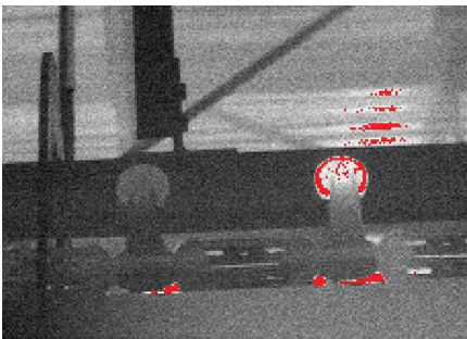
Рис. 5-52. Ненормальный нагрев подшипника конвейерной ленты может привести к чрезмерному расходу энергии и со временем к растяжению цепи.
