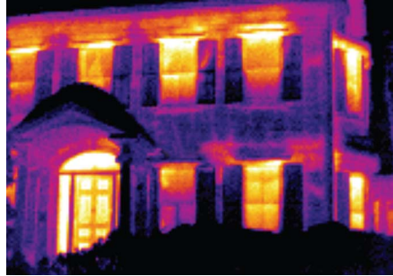
Рис. 5-49. Области с отсутствующей теплоизоляцией проявляются в виде теплых участков на внешних стенах здания в холодную погоду.
