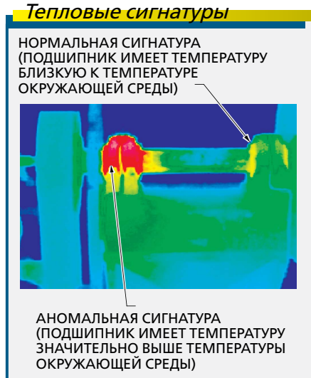
Рис. 6-3. Сцепления и подшипники валов двигателя, работающие нормально, должны иметь тепловую сигнатуру, которая будет очень близкой к значению температуры окружающего воздуха.
