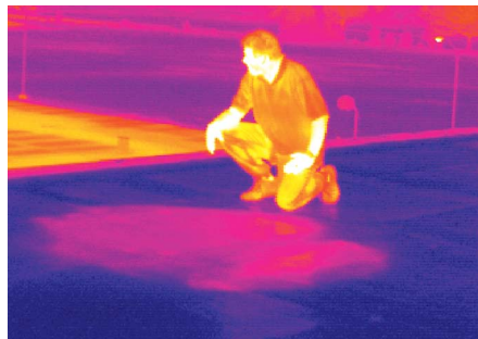
Рис. 5-53. Область с влажной теплоизоляцией крыши проявляется в виде теплого участка на крыше ранним вечером, когда условия самые подходящие для тепловизионной съемки.
